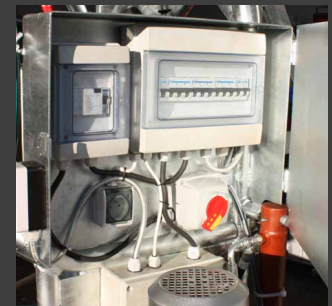
Armoire avec disjoncteur, prise 220v et interrupteur de mise en service
