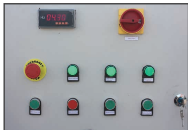
Panneau électrique de mise en service
