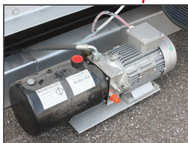
Moteur électrique avec réservoir d'huile pour l'inclinaison du tapis par vérin hydraulique
