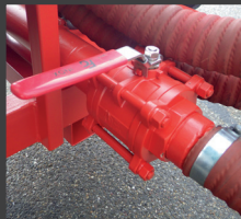
Vanne d'alimentation pompe/citerne
