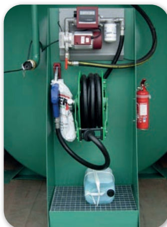
Bac de rétention et extincteur à poudre
