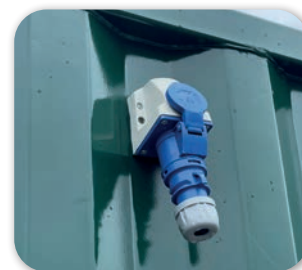
Prise extérieure de raccordement électrique
