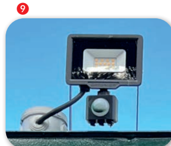
Eclairage extérieur d'approche
