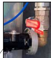
Vanne pour couper l'alimentation vers la pompe
