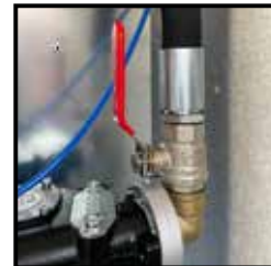
Vanne pour couper l'alimentation vers la pompe
